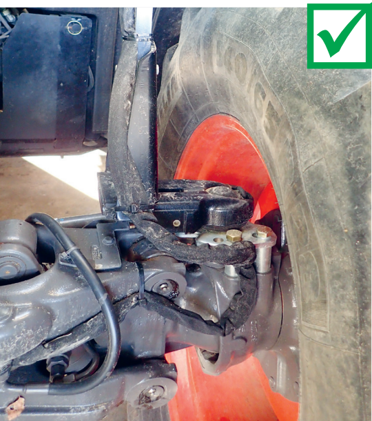
Fachgerecht montierte Leitungen
